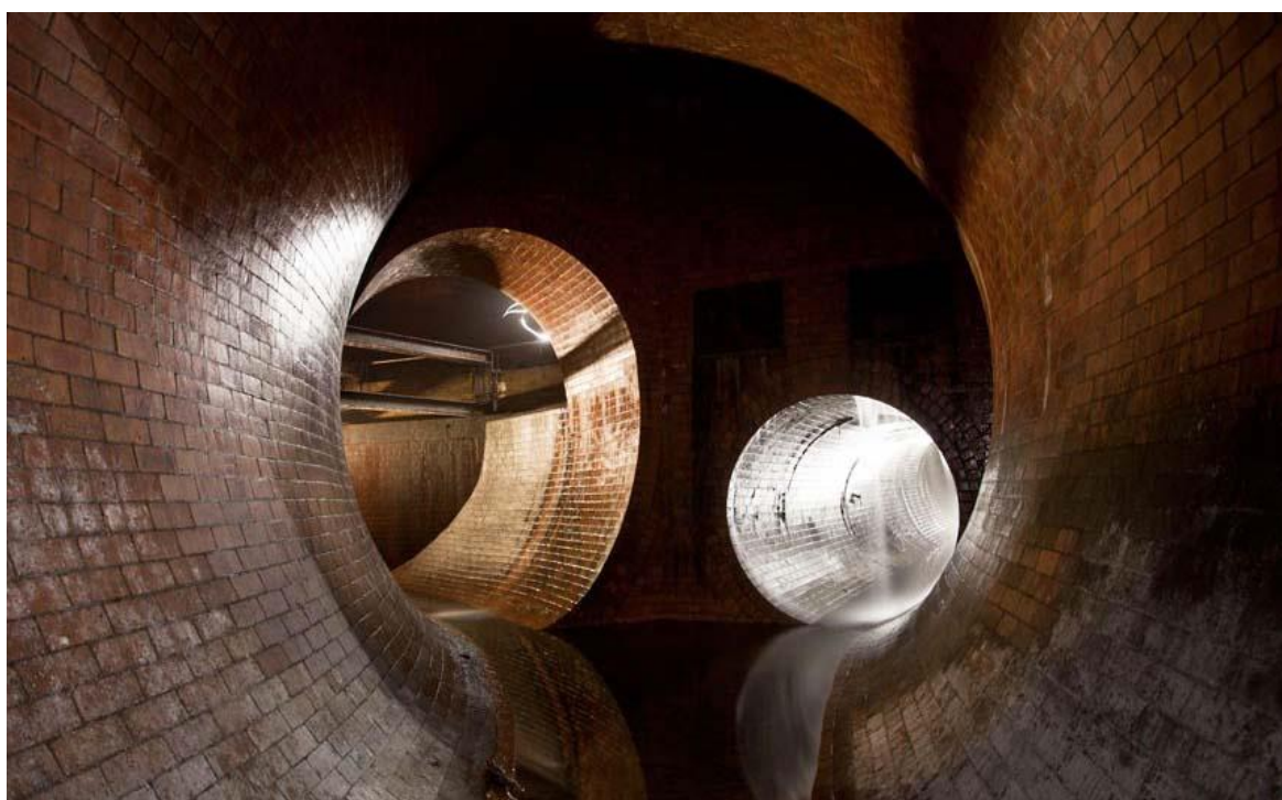
Hình 7. Một cống thoát nước, trước đây là sông Westbourne, bên dưới Knightsbridge ở London.
